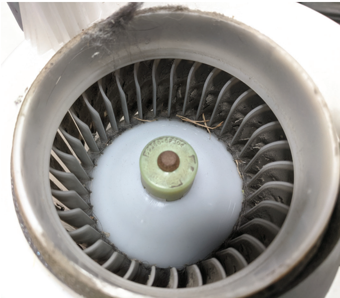
HV Battery Fan
